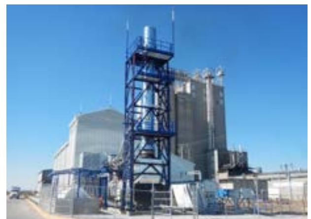
Planta de Cogeneración
